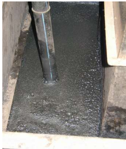
Figura 29. Sistema de Tratamento de água
