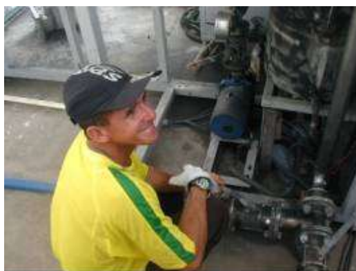
Figura 48 – Morador da comunidade operando o sistema de gaseificação Fonte: CENBIO, 2004h.
