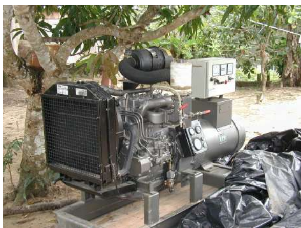
Figura 35 - Grupo Gerador da usina de óleos vegetais Fonte: CENBIO, 2003d.
