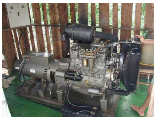
Figura 34 - Grupo Gerador Fonte: CENBIO, 2003d.
