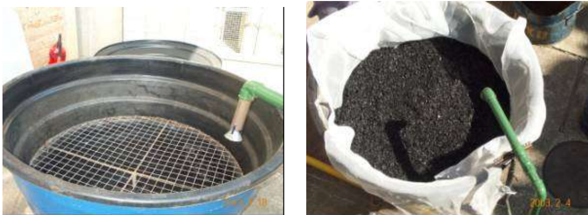
Figura 64 - Filtro com a grelha coberta com tela de sustentação de areia e de carvão Fonte: USHIMA, 2003c.
