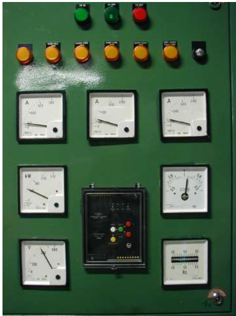
Figura 27. Quadro da saída de força da usina
