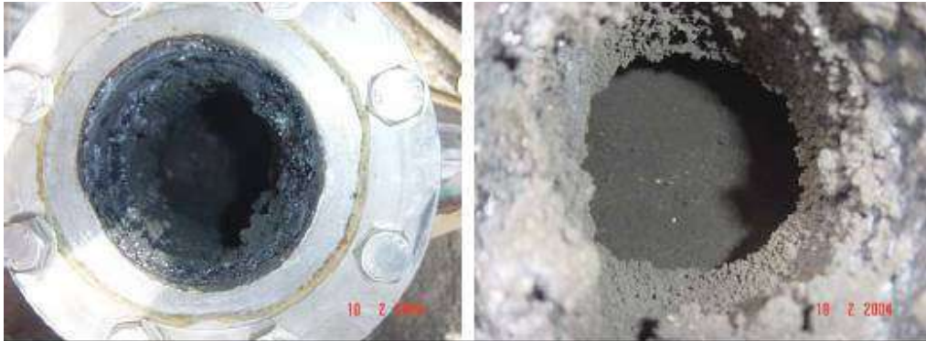
Figura 68 - Depósitos formados na entrada e saída do dispositivo de coleta inercial, instalado após o trocador de calor
