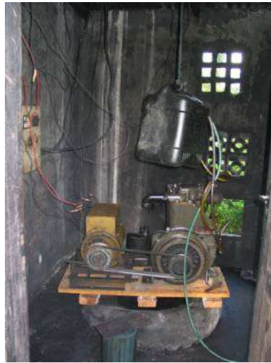
Figura 31 - Grupo Gerador Fonte: CENBIO, 2003d.
