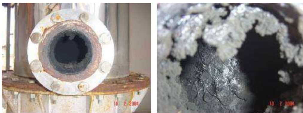
Figura 67 -Fotos do material depositado na entrada (à esquerda) e na saída do trocador de calor (à direita)
