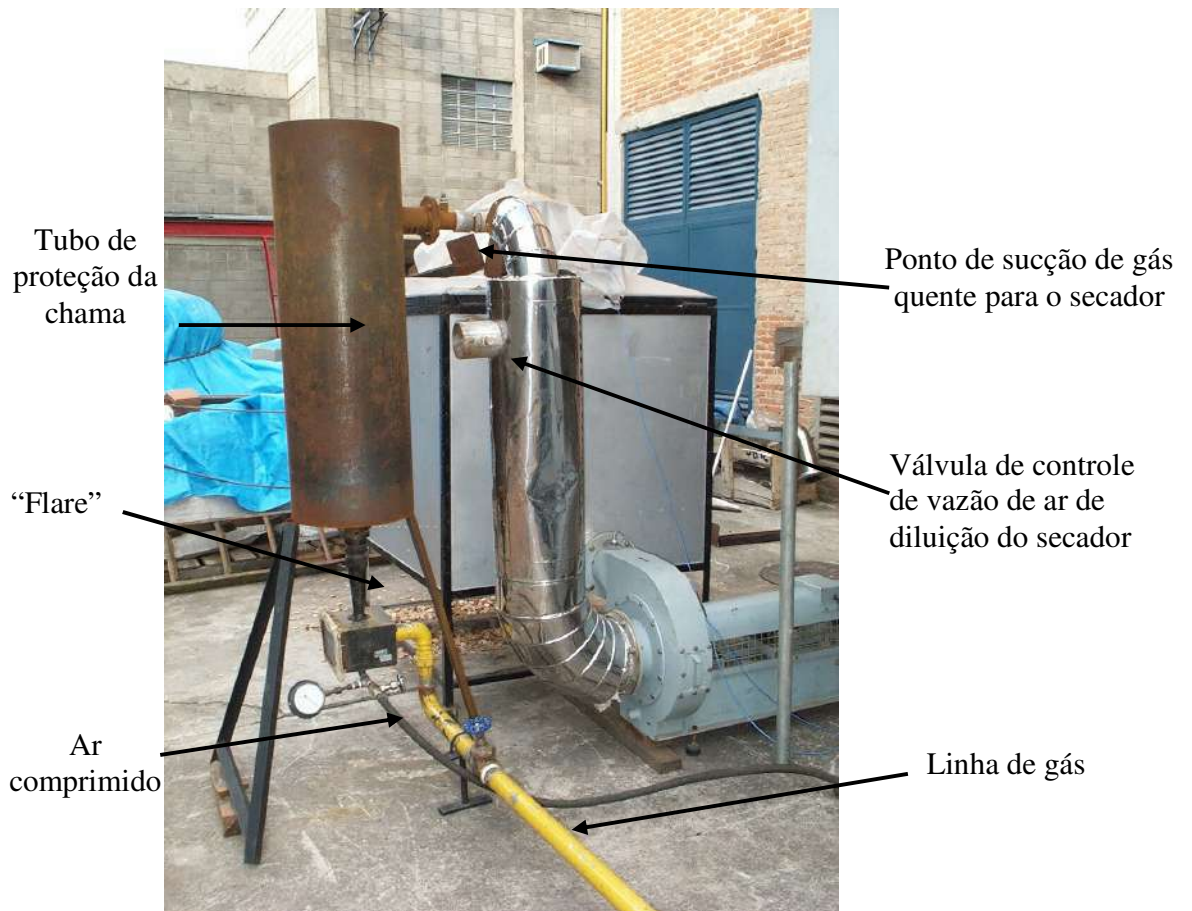
Figura 53 - “Flare” com injeção de ar comprimido
