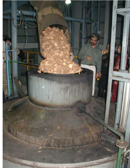
Figura 26. Topo do Gaseificador sendo alimentado com biomassa
