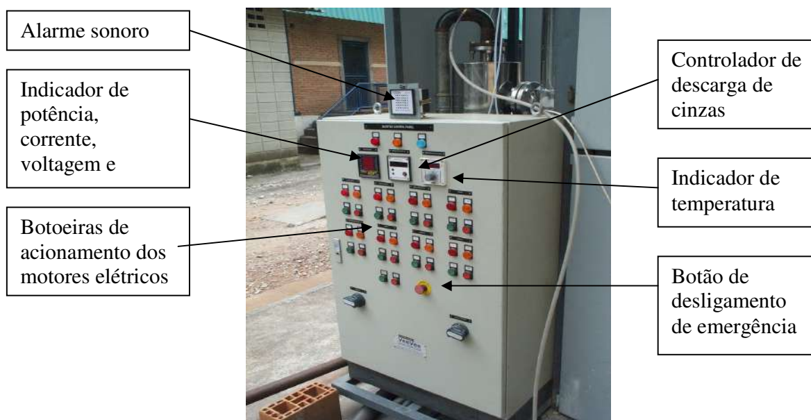
Figura 44 - Foto do painel de controle do conjunto Fonte: USHIMA, 2003c.
